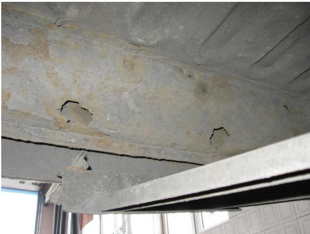
Zdjęcie nr 7 Nieprofesjonalne wykonanie napraw spawalniczych skutkujące uszkodzeniami elementów konstrukcyjnych.
