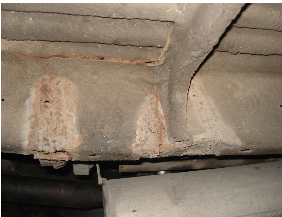
Zdjęcie nr 2 Nieprofesjonalne wykonanie napraw spawalniczych skutkujące uszkodzeniami elementów konstrukcyjnych.
