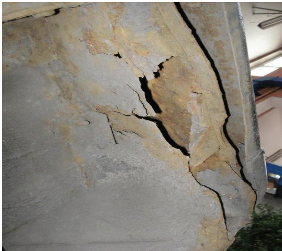
Zdjęcie nr 6 Uszkodzenia elementów konstrukcyjnych podłogi (widok z dołu).
