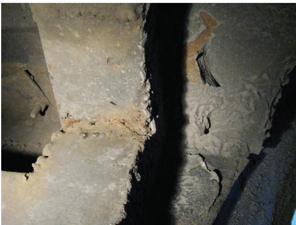
Zdjęcie nr 8 Nieprofesjonalne wykonanie napraw spawalniczych skutkujące uszkodzeniami elementów konstrukcyjnych.
