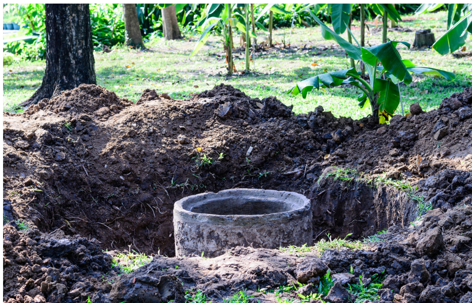
Zdjęcie nr 2 Studzienka kanalizacyjna
