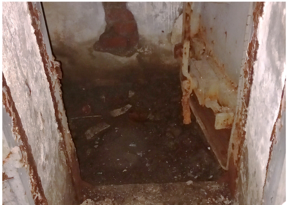
Zdjęcie nr 12 Zdewastowane przejście do wyjścia zapasowego w obiekcie na terenie gminy Wałbrzycha
