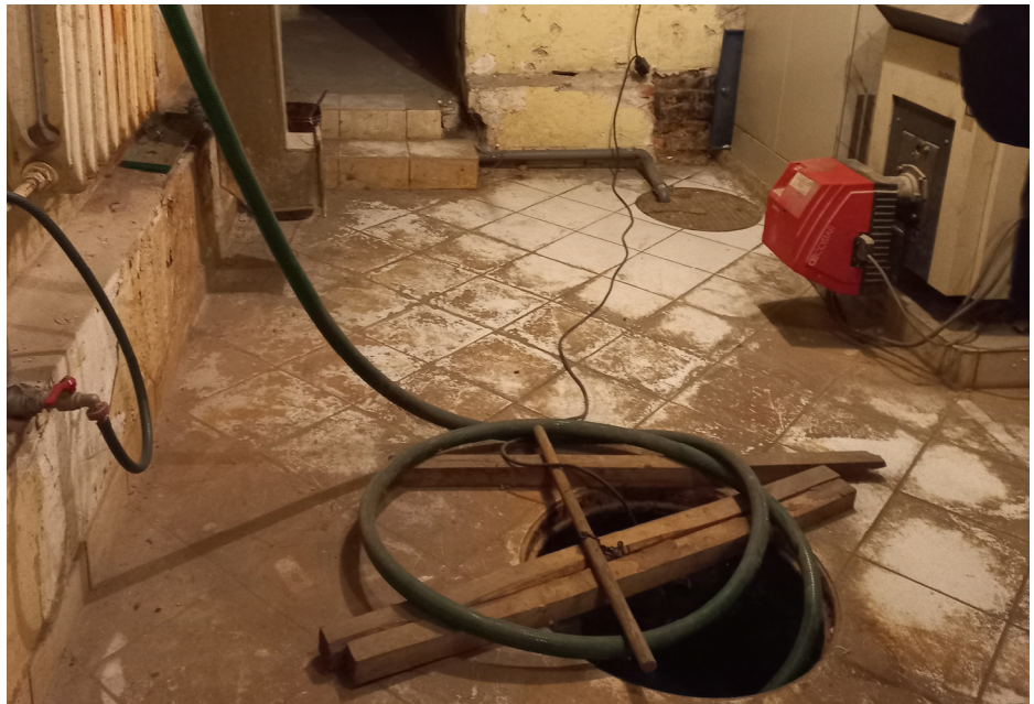
Zdjęcie nr 11 Cyklicznie zalewane pomieszczenie jednej z budowli ochronnych na terenie Ostrowca Świętokrzyskiego
